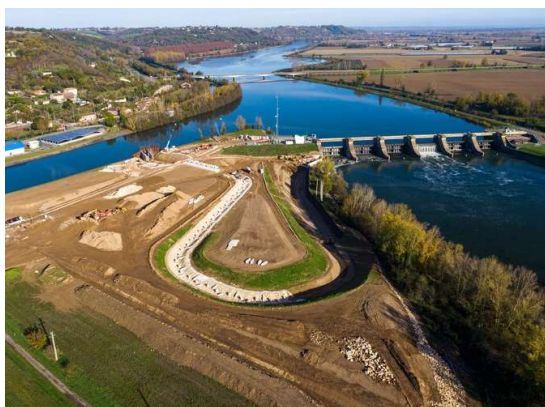
Photo 10 : Vue aérienne de la rivière de Malause pendant la phase de travaux (source : EDF)
