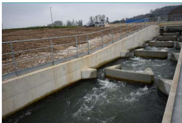
Photo 11 : Vue de la section en passe à bassins à 2 fentes verticales du dispositif de franchissement de Malause (source : OFB)
