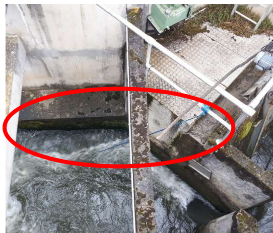
Photo 28 : Antenne amont (antenne brin) installée en amont de la passe à poissons de l'usine du Ramier
