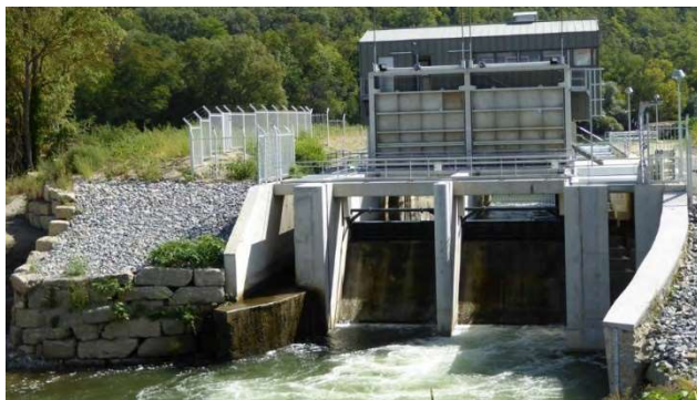
Photo 18 : Vue aval de l'aménagement de la Cavaletade avec l'entrée de la passe à bassins à droite de la sortie des turbines (source : MJ2 Technologies)
