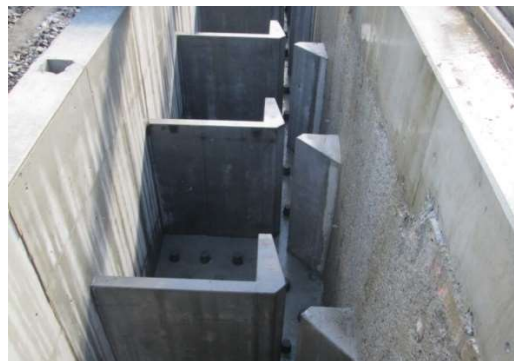
Photo 19 : Vues des bassins de la passe à poissons avec implantation des rugosités de fond (source : Farcimar)
