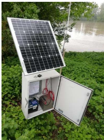
Photo 26 : Installation de station d'enregistrement radio autonome
