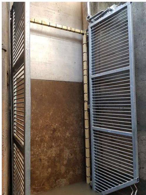
Photo 33 : Antenne GO10000 à l'entrée 1 de l'ascenseur (avant retrait de l'anti-retour)
