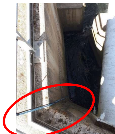
Photo 30 : Antenne amont (antenne brin) installée en amont de la passe à poissons de l'usine de la Cavaletade
