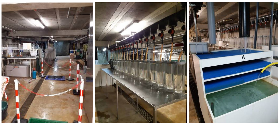
Figure 10 : Installation du matériel dans le laboratoire dédié à la reproduction
