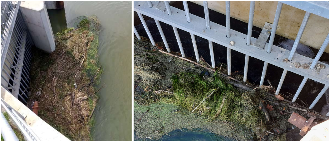
Figure 46 : Colmatage des grilles de prise d'eau de la passe à poissons de Malause
