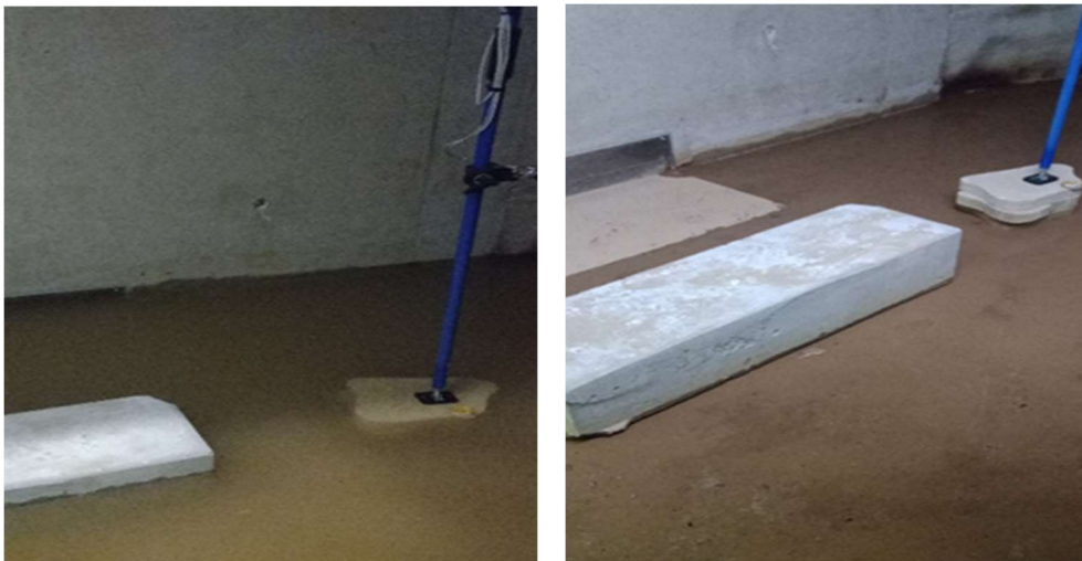
Figure 48 : Photographies des infiltrations d'eau à Malause en 2023
