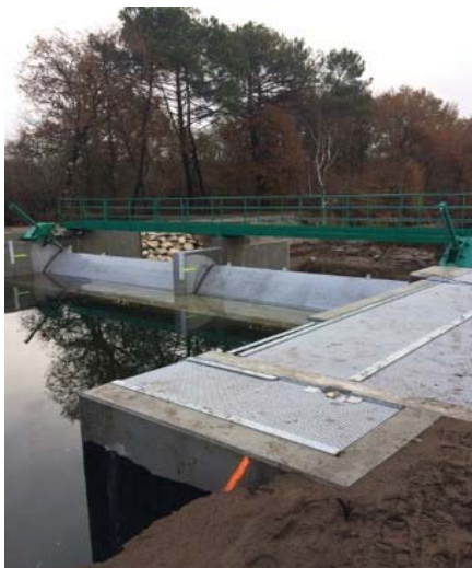
Figure 16 : Photo de la nouvelle écluse (vannes fermées) * au premier plan le coffret béton dans lequel la caméra est installée
