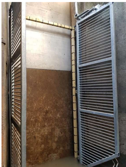
Photo 35 : Antenne GO10000 à l'entrée 1 de l'ascenseur
