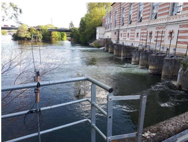
Photo 29 : Antenne aval (antenne boucle) installée à l'entrée de la passe à poissons de l'usine du Ramier
