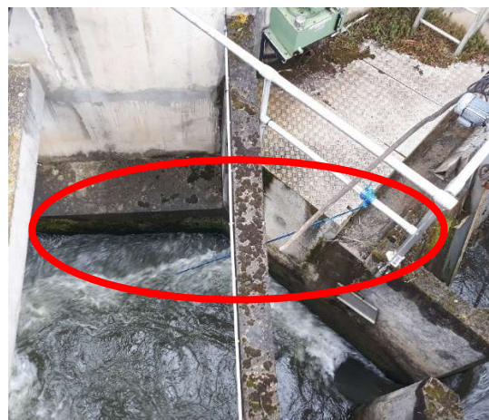
Photo 30 : Antenne amont (antenne brin) installée en amont de la passe à poissons de l'usine du Ramier
