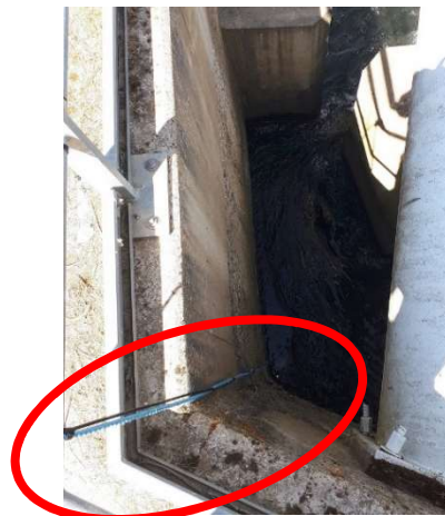
Photo 32 : Antenne amont (antenne brin) installée en amont de la passe à poissons de l'usine de la Cavaletade
