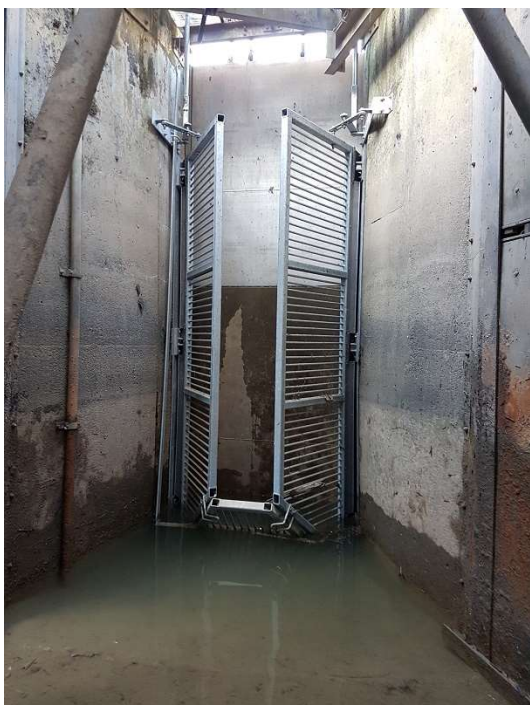
Photo 6 : Nouveau système anti-retour au niveau de l'entrée 1
