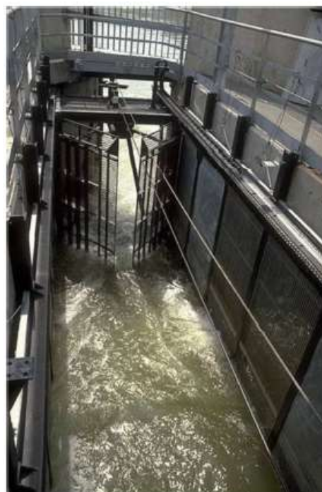
Photo 7 : Système de grille anti-retour du bassin de stabulation
